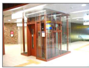
エレベーター
