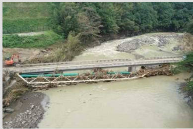
＜被災して崩落した水道管＞
